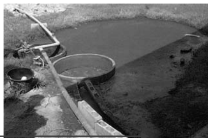
รูปที่ 7.2-4 ระบบรวบรวมน้ำเสีย ที่ม่านน้ำเสียเอ่อล้นออกนอกรางและบ่อรวบรวมน้ำเสีย
